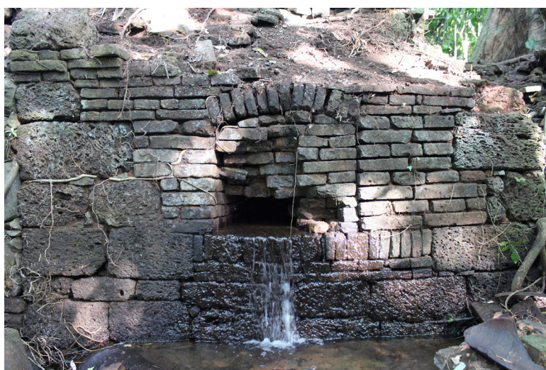
Figure 6 Fenêtre permettant l'évacuation de l'excédent de la retenue d'eau
