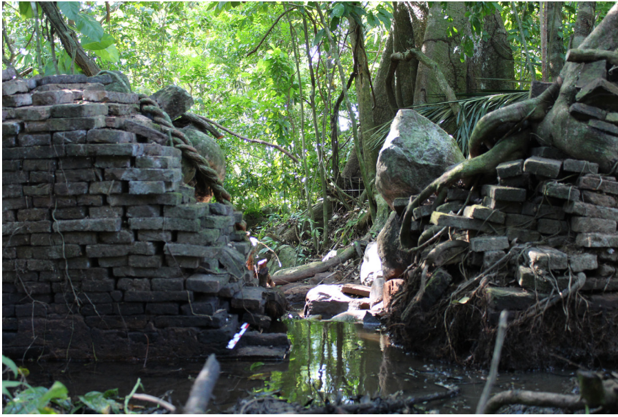
Figure 7 Zone arrachée du barrage poids
